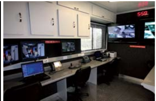
Central de despacho
