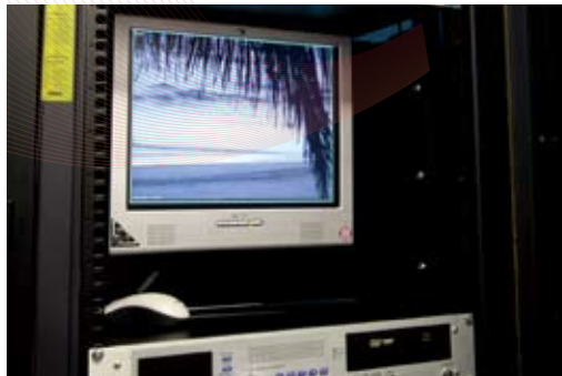
Control de vigilancia
